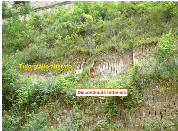
Figura 22: tufo alterato, alla base della parete sudoccidentale, interessato da discontinuità tettonica
