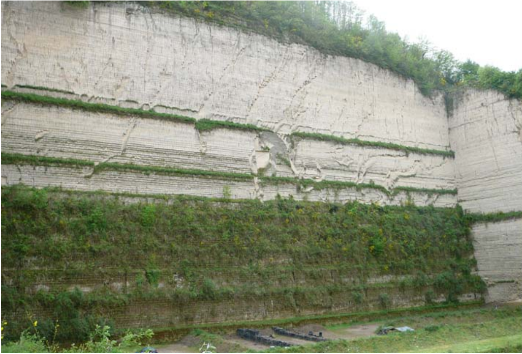
Figura 11: Evidenze dell'intensa fratturazione e dei prismi di tufo crollati negli anni scorsi dalla parete sudorientale. Le discontinuità tettoniche sono subparallele e immergenti a franapoggio meno inclinate del pendio. Lo spessore di tufo delimitato dalle discontinuità varia da qualche metro a circa 7-8 metri. La parte inferiore della parete è costituita da tufo visibilmente alterato e in gran parte pedogenizzato in superficie
