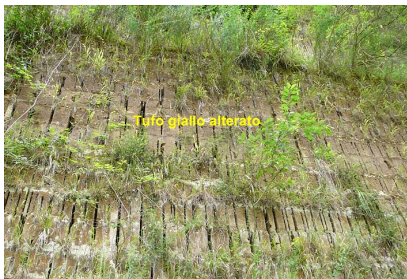
Figura 21: tufo alterato alla base della parete sudoccidentale
